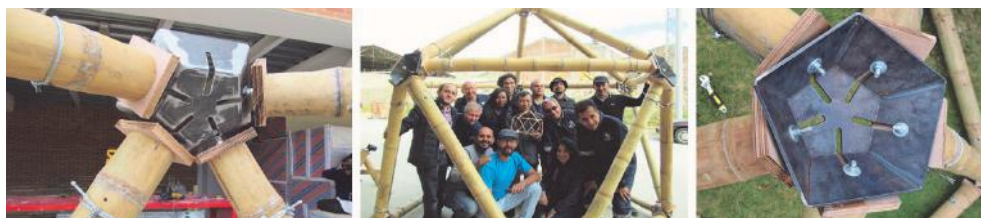
2 Fabricación de Domo con uniones de compresión radial propuestas por Widyowijatnoko, A.
